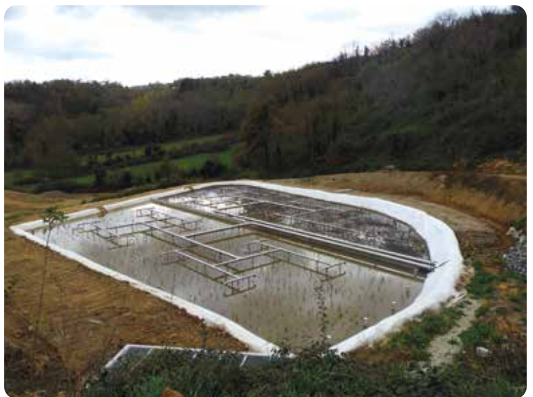
1 er bassin de la nouvelle station d'épuration au Barois mis en service fin octobre
